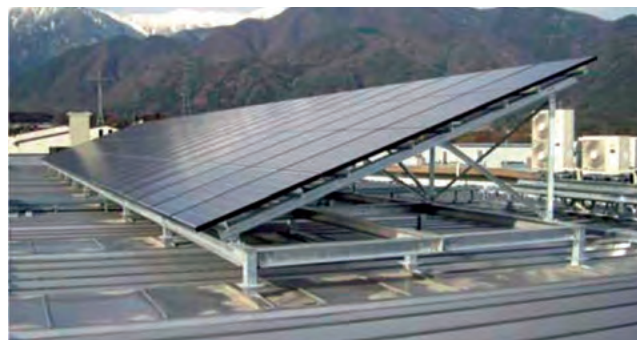
DDS駒ヶ根工場(20kW)(2008年度稼動開始)
