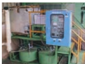
ジクロロメタンの再生施設
